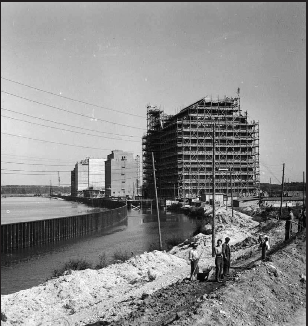
Albern, Blick auf Getreidespeicher und Kaimauer ( Spundwand ) am Südufer des Hafenbeckens (Sommer 1941)
